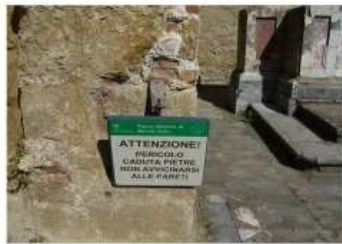
Chiesa di Casaglia. Pericolo caduta pietre
